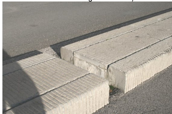
Dettaglio 2 – particolare interruzione per scolo acque
